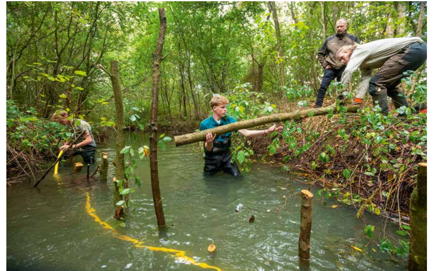
Jarno Pater (l), Raf van Dinteren (m) en Ricardo van Zanten (r) plaatsen de palen in een driehoek in de Egelbeek. Docent Bas Wrekenhorst kijkt toe.
